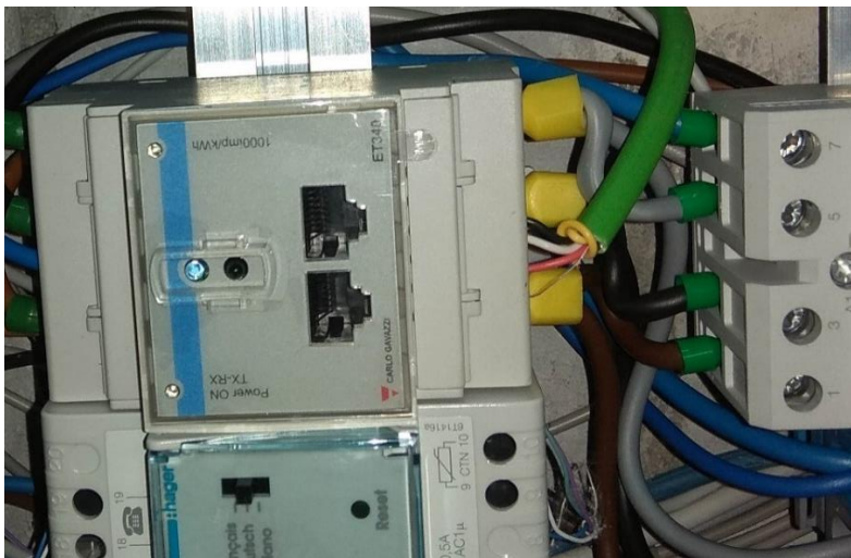
Abb. 10: Eingebautes Messgerät Carlo Gavazzi ET340
