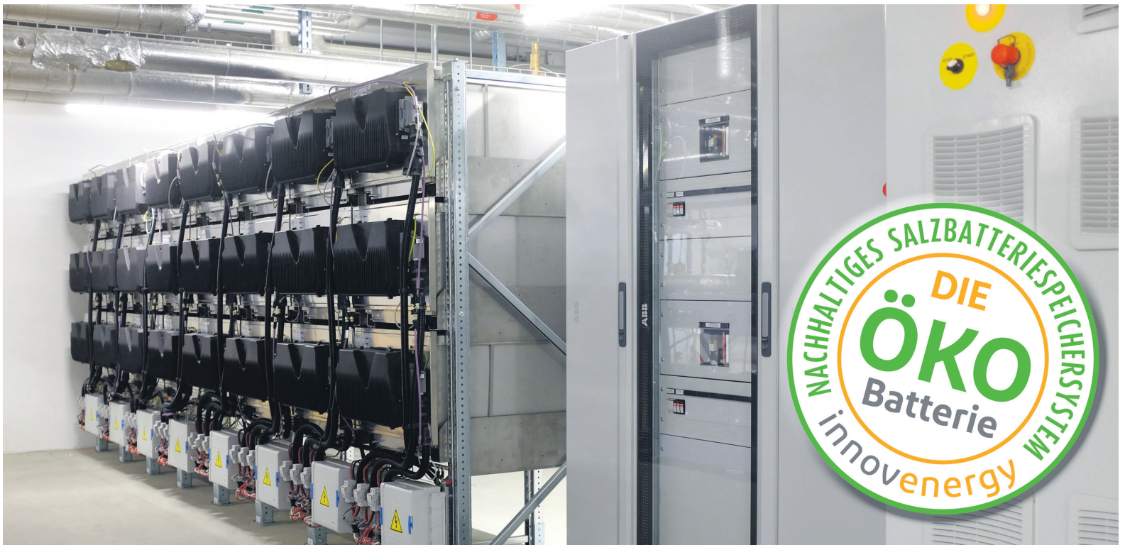
Der 540 Kilowattstunden-Grosspeicher mit 22 Salz Batterien von innovenergy in der MIGROS Schlieren/ZH
